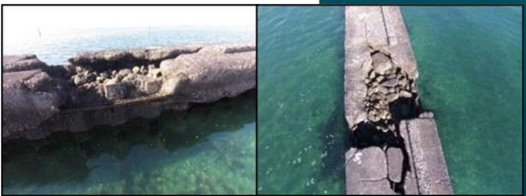
防泥柵上部コンクリートの欠損状況
